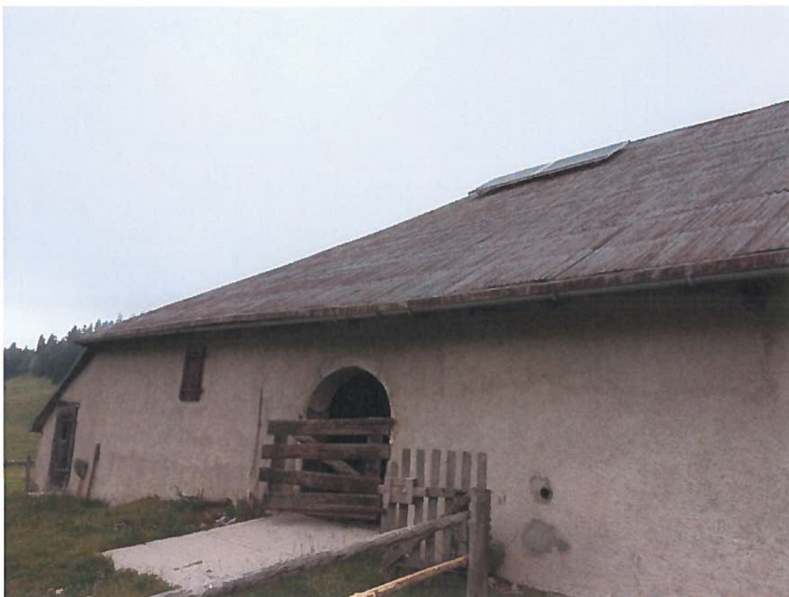
Panneau solaire photovoltaïque / côté sud
