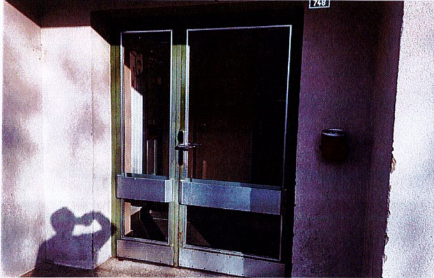
Porte d'entrée à changer
