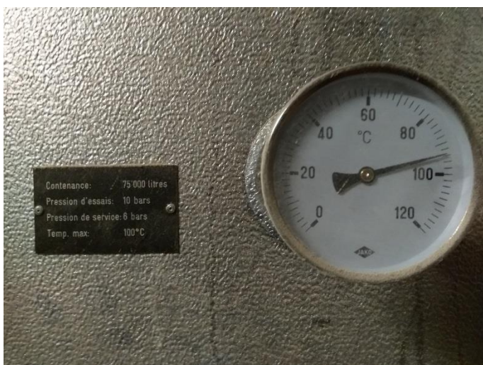
Réservoir tampon de 75'000 litres d'eau chaude
