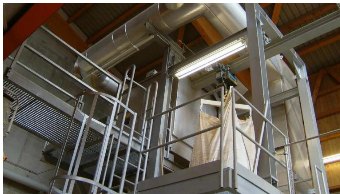
Système de filtration des fumées (© Eltecna AG)
