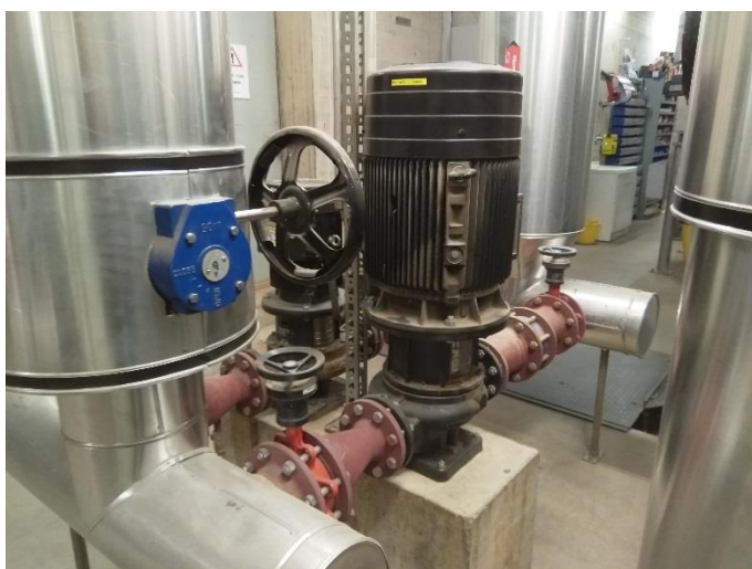
Pompe de circulation du réseau Le Sentier
