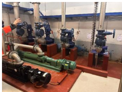
Photo 4 - Pompes de relevage de la STEP
