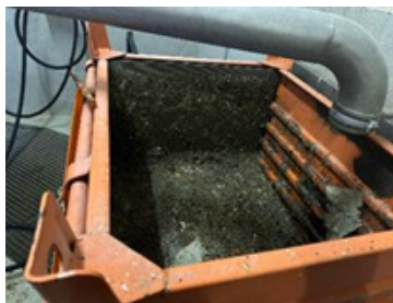
Photo 2 - Extrait du dégrilleur
