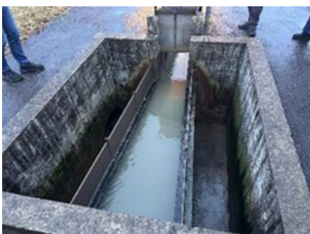
Photo 5 - Déversoir d'orage après décanteur primaire
