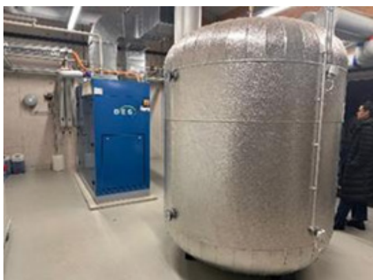
Photo 8 – Couple chaleur-force (CCF)
