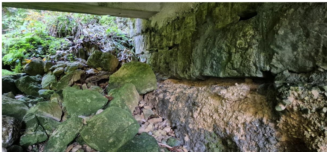
Image 7 – Affouillement sous la culée du pont amont
