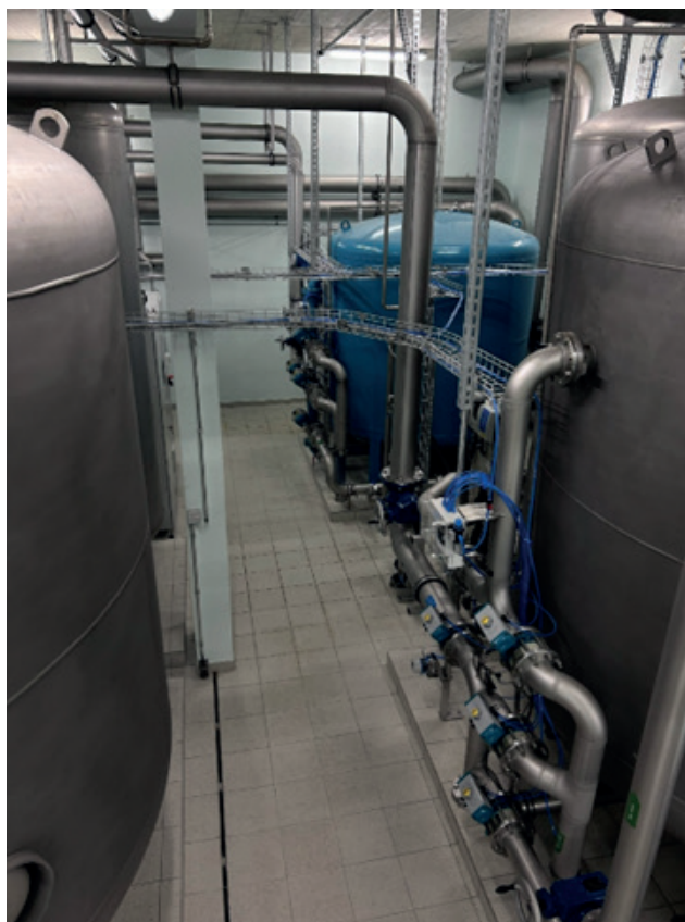
Image 1 – Intérieur station de filtration
